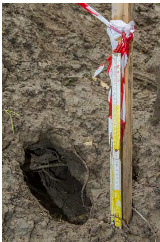
Figura 68 – Tana di animale selvatico osservata, immediatamente a valle della tratto collassato, durante il sopralluogo del giorno 19-02-2014.
